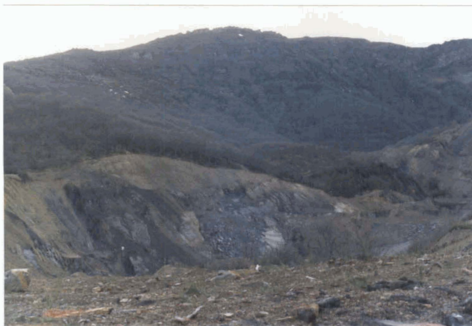
FOTO 8.2.- LAS BALSAS SE ENCUENTRAN ENCADENADAS SOBRE LA TERRAZA DEL RIO CARRION. OBSERVESE LA SOCAVACION REALIZADA AL PIE DE UNO DE LOS DIQUES DE LA ESTRUCTURA
